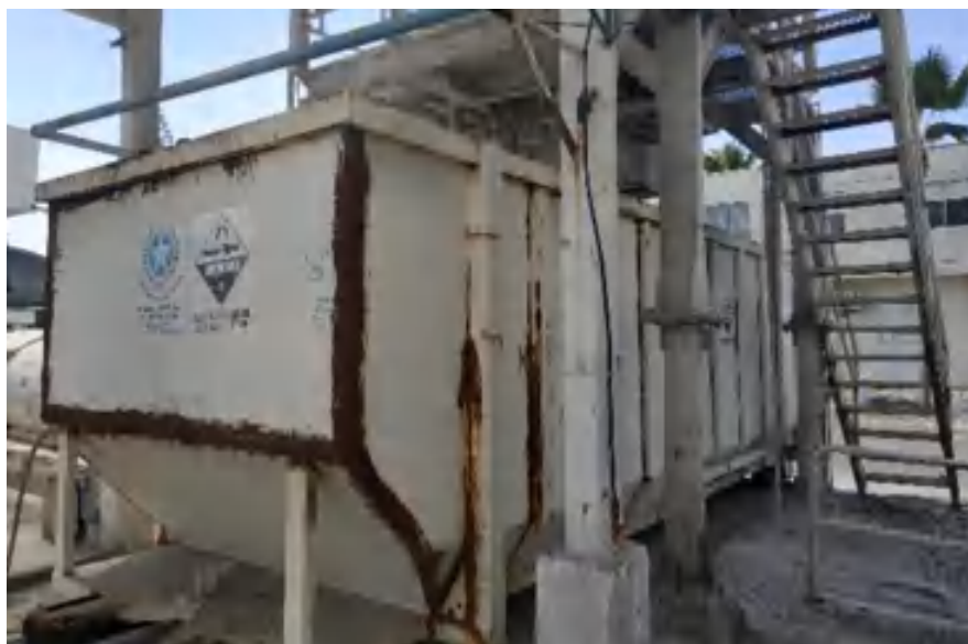
Fotografía 47. Tanque metálico para almacenamiento de la lechada de cal
