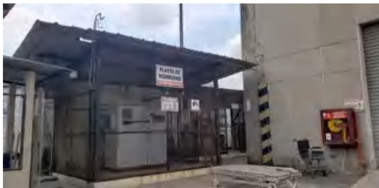
Fotografía 40. Planta de hidrógeno que forma parte de la planta ASU inertizada
