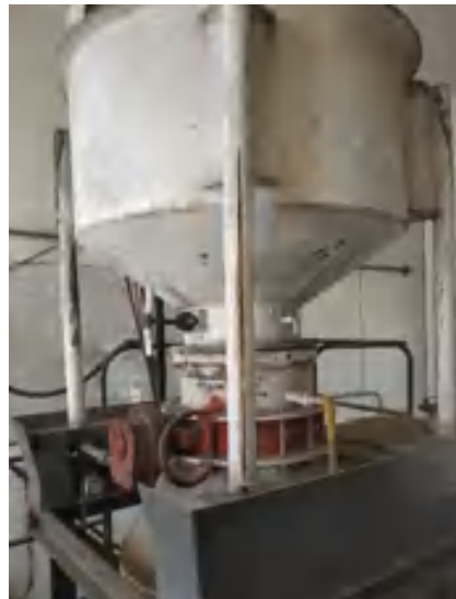
Fotografía 36. Producción de Acetileno - Compresión
