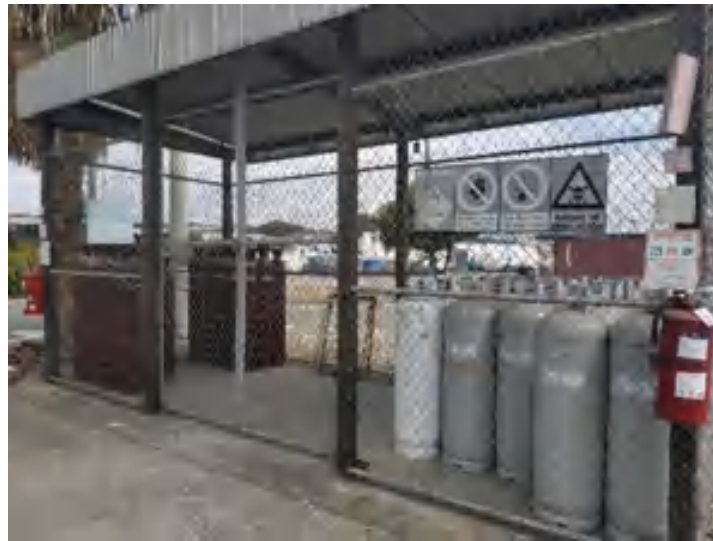
Fotografía 22. Bodega de almacenamiento de gases tóxicos
