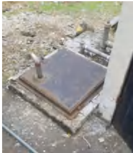
Fotografía 32. Área sistema contra incendios
